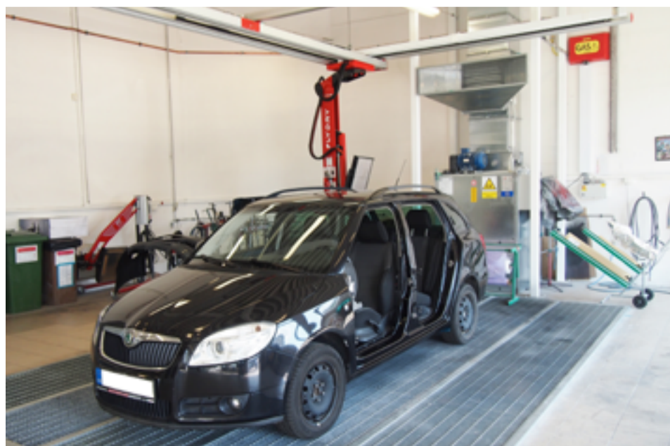
Roštové přípravné stání s odsáváním osazené sušícím robotem Symach Flydry.
