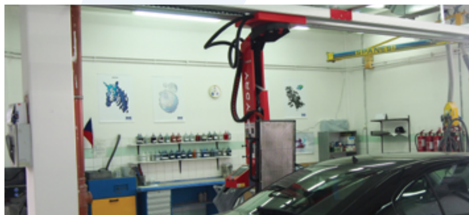
Přípravné stání se stěnovým odsáváním a sušícím robotem Flydry.
